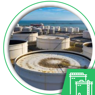
LNG / Tank Terminal
